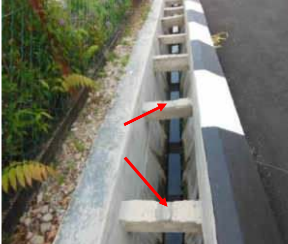
Gambar Sebelum : Kerja tidak kemas di mana 'struts' tidak dilepa.
