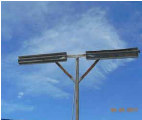
Gambar sebelum: Kerosakan lampu tidak dibaiki dan diganti. Tarikh lawatan pada 04.04.2017.
