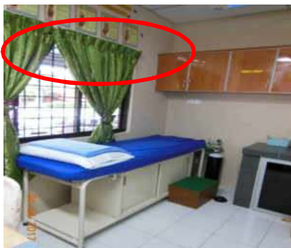
Gambar sebelum: Curtain railing untuk screen coach tidak dibekal. Tarikh lawatan pada 05.04.2017
