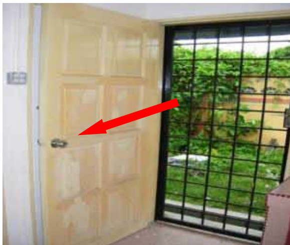
Gambar Sebelum: Contoh pintu sedia ada tidak diganti . Tarikh lawatan pada 26.04.2017.
